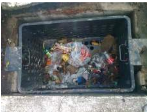
Figura 5.14 – Caixa de resíduos em operação na boca de lobo
