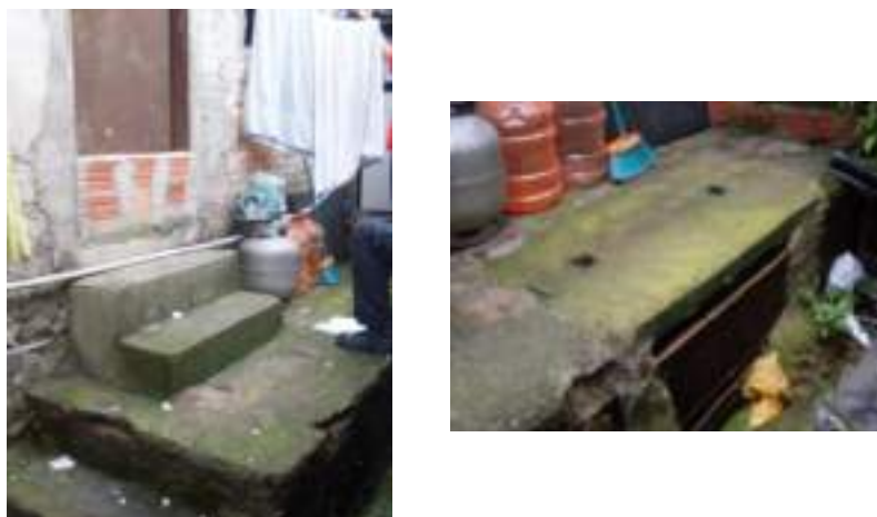
Figura 28.28 – Contenção realizada por morador para evitar entrada de água da chuva e boca de lobo existente sob a casa
